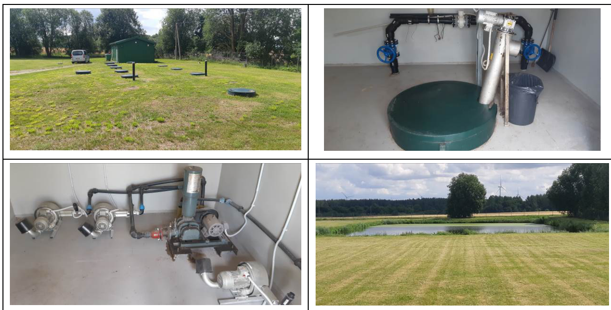
Joonis 12. Viru-Nigula aleviku reoveepuhasti. Fotod: OÜ Alkranel 18.07.2024.
