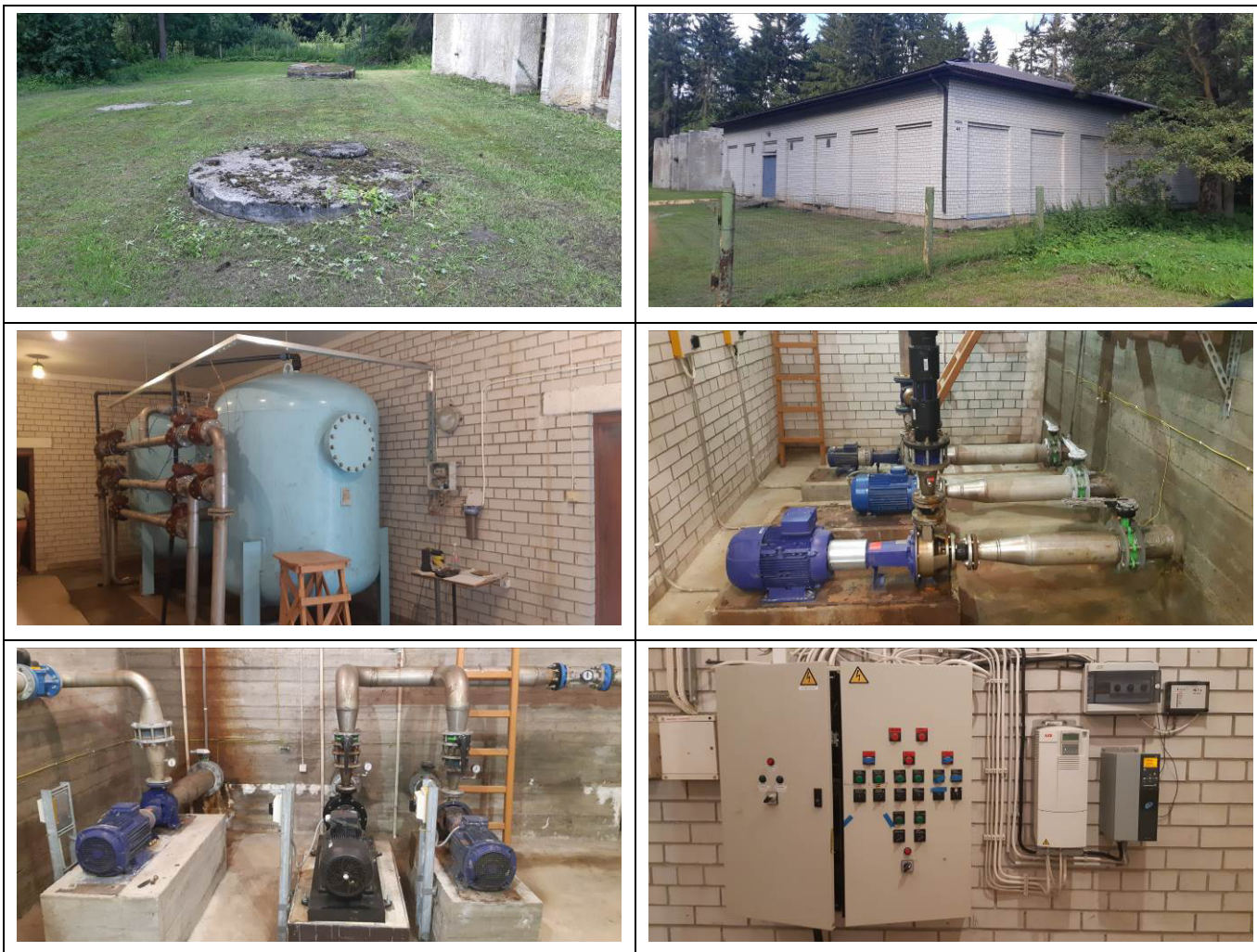
Joonis 3. Kunda linna Koidu tn puurkaevud (katastri nr-id 2775 ja 2776) ning veetöötlusjaam. Fotod: OÜ Alkranel 18.07.2024.
